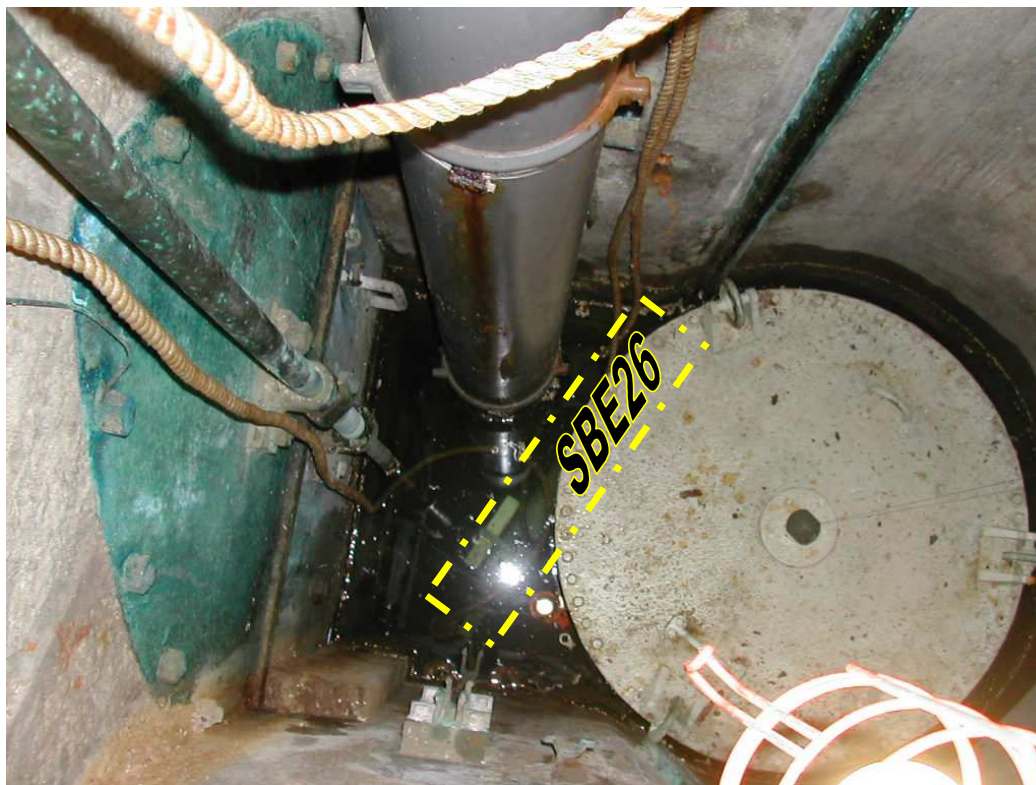
Fig. 3 : Indication de la position du marégraphe SBE26 (pointillés jaunes) dans le puits de tranquillisation du marégraphe à flotteur de Marseille. Le tube PCV de quelque 30cm correspond au marégraphe MCN à ultrasons.
